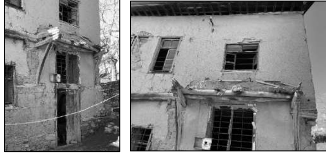
Şekil 8. Güneydoğu cephesinde yer alan cumba kalıntısı
