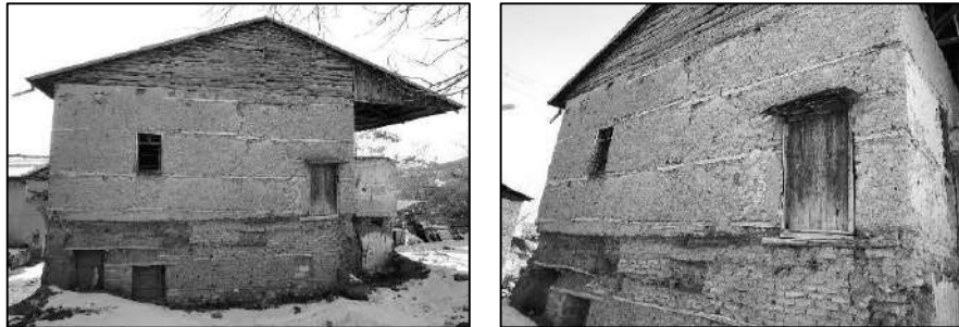
Şekil 12. Kuzeydoğu cephesinde yer alan ahşap elemanlardaki hasarlar
