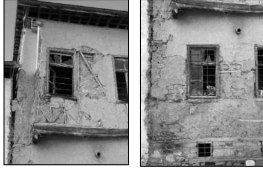
Şekil 7. Güneydoğu cephe duvarındaki yapısal hasarlar
