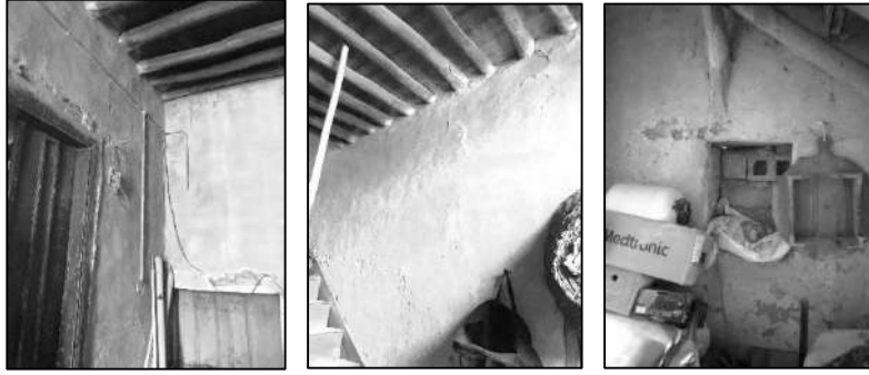
Şekil 17. Eyvan bölümü duvarlarındaki hasarlar
