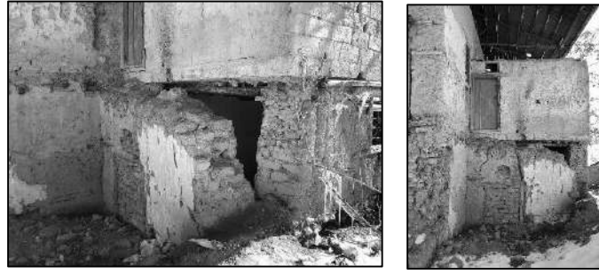
Şekil 13. Kuzeydoğu cephesinde yer alan duvarlardaki hasarlar
