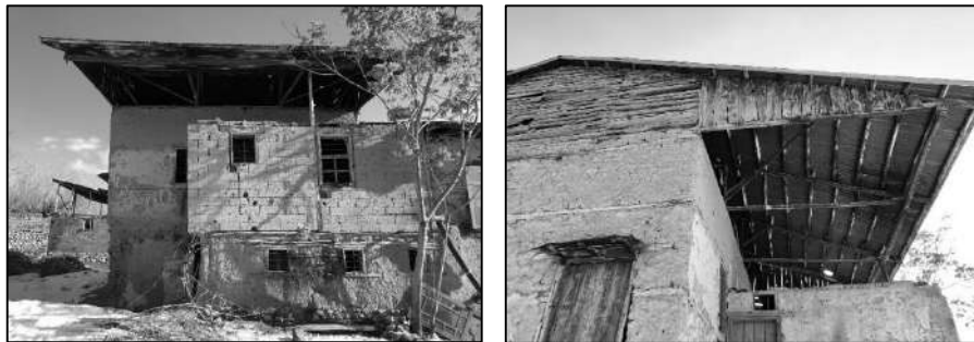
Şekil 15. Kuzeybatı cephesinde yer alan niteliksiz eklerin oluşturduğu hasarlar
