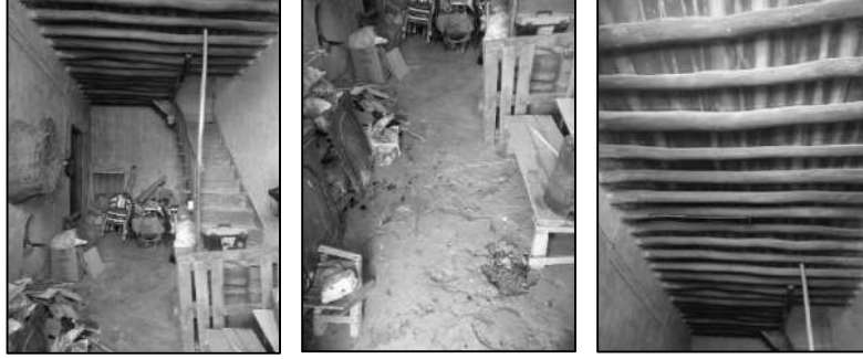
Şekil 16. Eyvan bölümündeki döşeme hasarları
