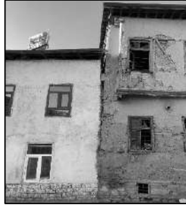
Şekil 10. Güneydoğu cephe duvarlarında aks kayması ve eğime hasarı
