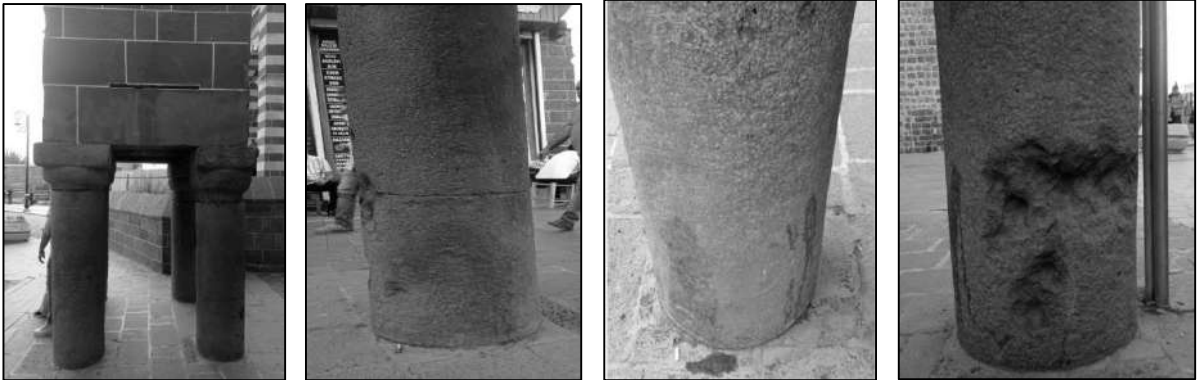
Şekil 6. Dört Ayaklı Minare sütunlarında meydana gelen malzeme kaybı hasarları (2023)
