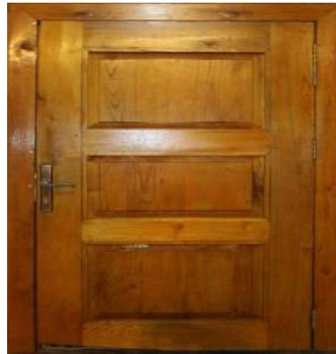
Değişmiş kapı, menteşe ve kilidi Göğceli Cami Kapısı (S-2)
